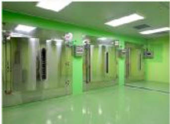
150升冷凍乾燥設備
