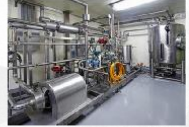
薄膜過濾設備
