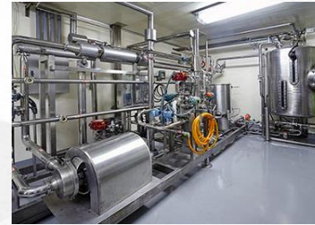
薄膜過濾設備
