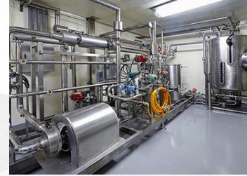
薄膜過濾設備
