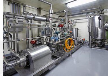
薄膜過濾設備
