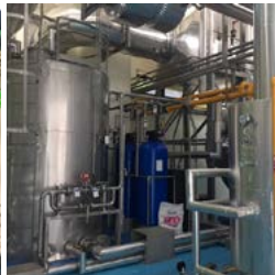
蒸汽冷凝水回收桶槽
